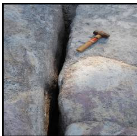
Figura 26. Fissura. Fonte: André Zumak.
