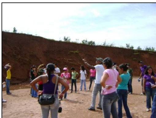
Figura 17. Ravina na margem esquerda do canal. Fonte: SILVA, C.H.R., 2009.
