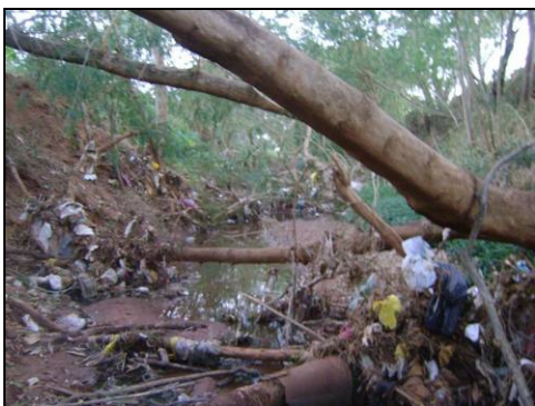
Figura 05. Canal obstruído pelos resíduos Fonte: SILVA, C.H.R., 2009.
