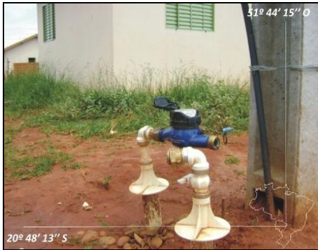
Figura 8. Falta d'água no Chácara Imperial. Fonte: Todos os autores, 2009.
