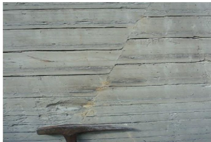
Figura 08. Falha decorrente da acomodação dos blocos. Localização: município de Trombudo Central/SC. Foto: Jéssica Kelly, 2010.
